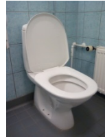
WC-laite (wc pönttö)
